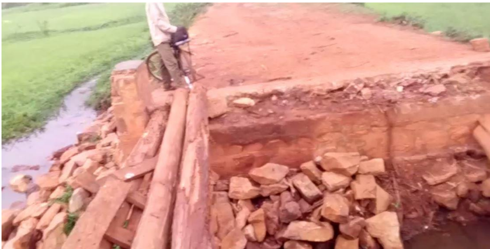
Photo du pont détruit
